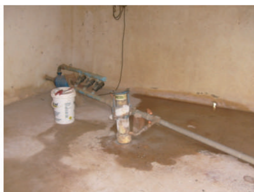
Foto 13 – Local de Tratamento da Água
